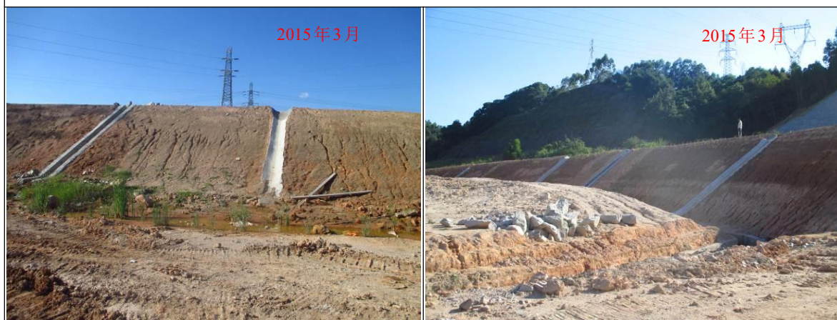
主线路基纵坡面设置临时砂浆抹面急流槽及永久浆砌石急流槽
