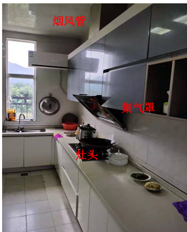
图 7.4-1 厨房集气罩及烟风管（通楼顶）
