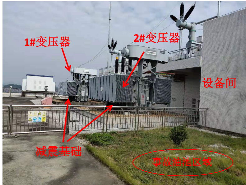
图 7.4-5 事故油池所在地
